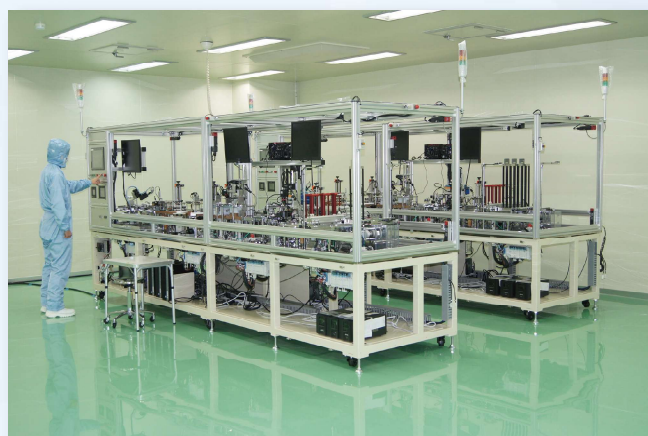
クラス10,000のクリーンルーム
