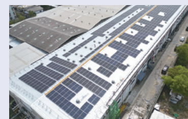
タイ現地法人の太陽光パネル
